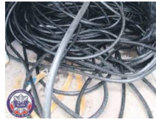
Ukradli przewód elektryczny wraz z oprzyrządowaniem, powodując straty na kwotę ponadto 4500 zł
