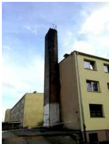
Strażacy z Parłina zostali zadysponowani do zabezpieczenia metalowych obręczy na kominie w miejscowości Storkówko. Foto. OSP. Parłino
