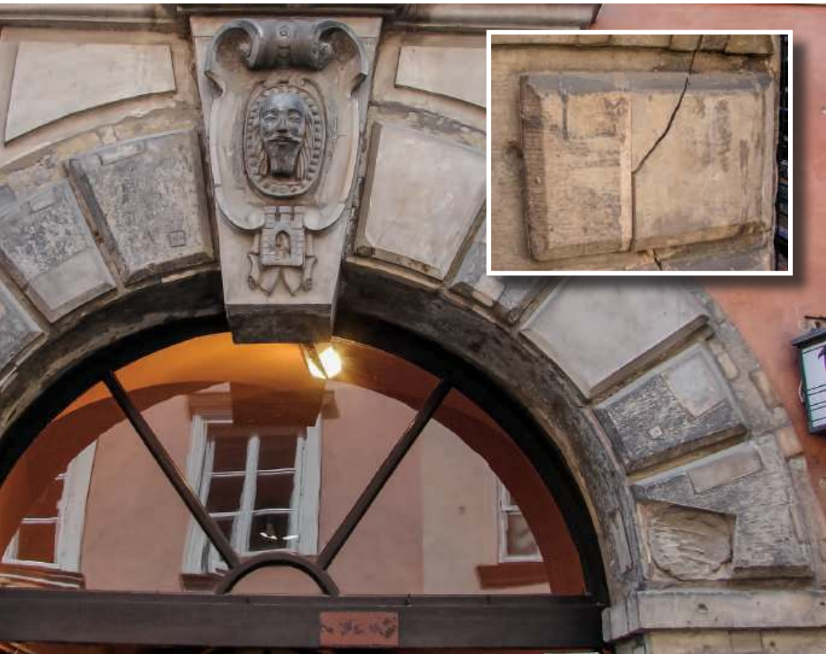
Portal kamienicy przy ul. Piwnej 13 i jego fragment z widocznymi pęknięciami
