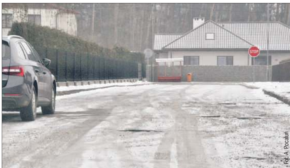
Osiedlowa droga ma coraz więcej dziur.
