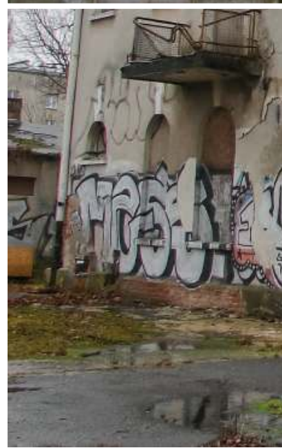
Niszczący budynek dawnej plebanii i jego portal od
