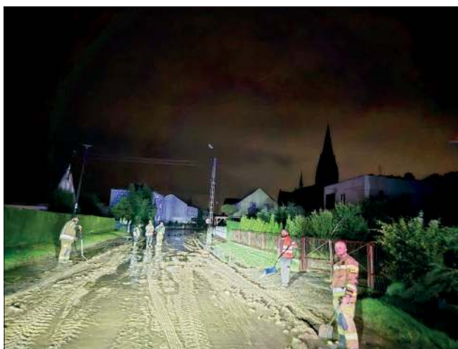
■ Drogi wypełniło błoto, strażacy mieli pełne ręce roboty
