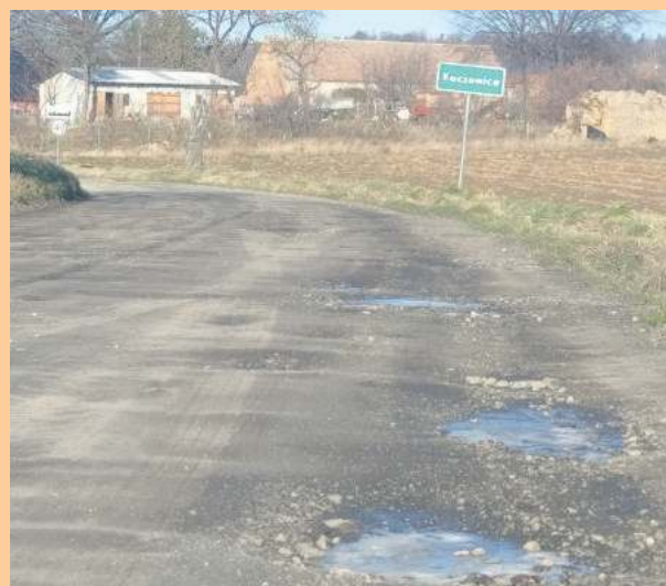
Na tak zdegradowanym odcinku trudno o komfort jazdy
