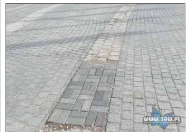
Kostka z ubytkami
