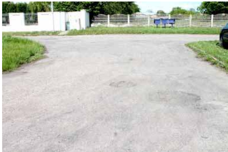
Taki jest stan odcinka drogi na Nowowiejskiej przy pętli autobusowej.
