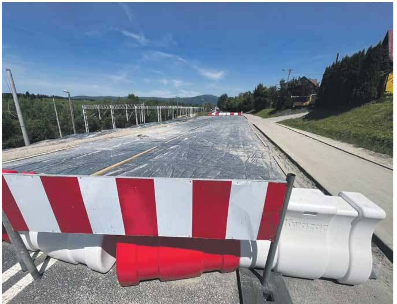
Od jesieni ubiegłego roku główny wjazd do Rabki pozostaje nieprzejezdny.
