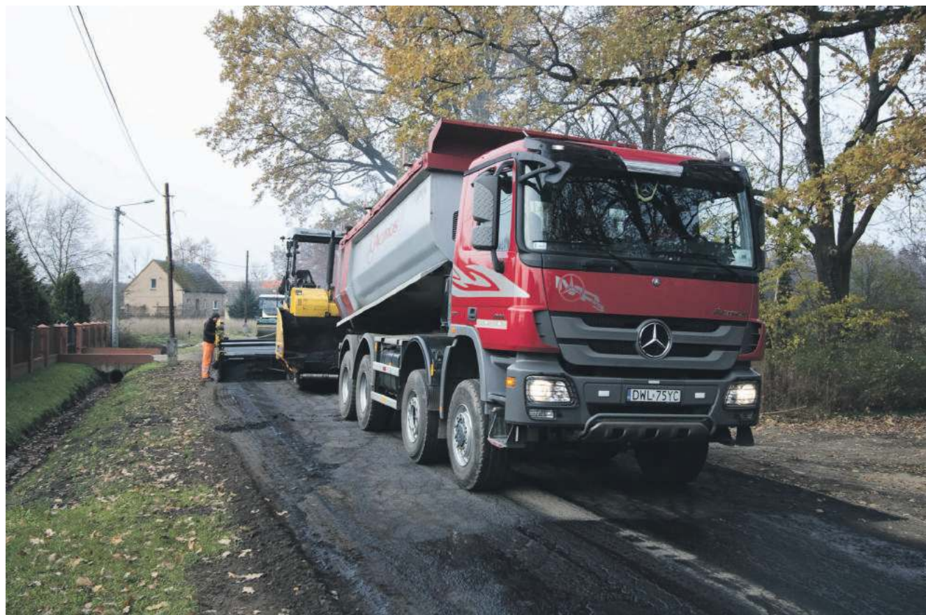
Drogi i chodniki to jedna z najważniejszych potrzeb mieszkańców.
