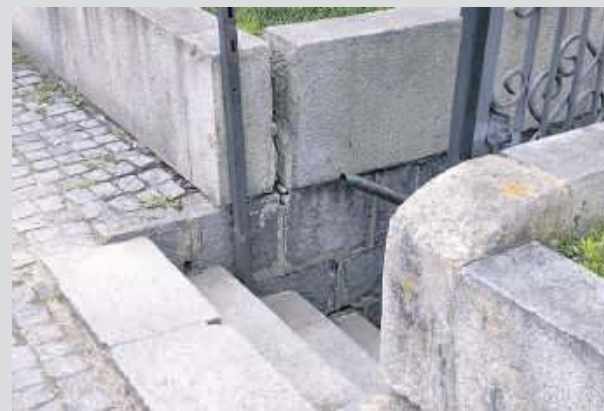
Blok granitu poluzował się i wymaga interwencji budowlanców
