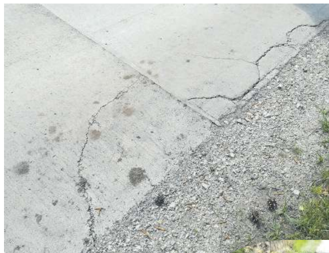
Nawierzchnia ścieżki jest popękana
