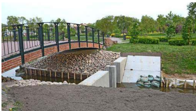
Prace wymagają interwencji w skarpy.
