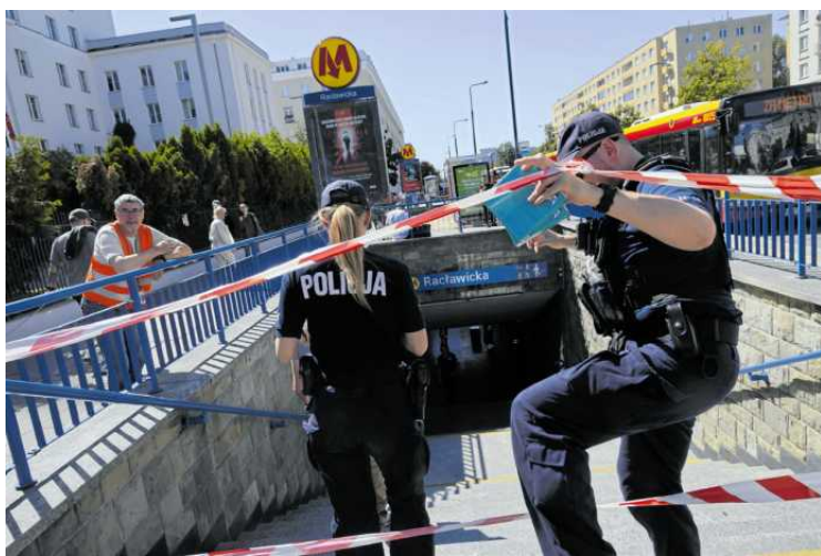
• Pożar wybuchł w kanale z kablami przy rozdzielni prądu na mokotowskiej stacji Raclawicka w nocy z poniedziałku na wtorek
