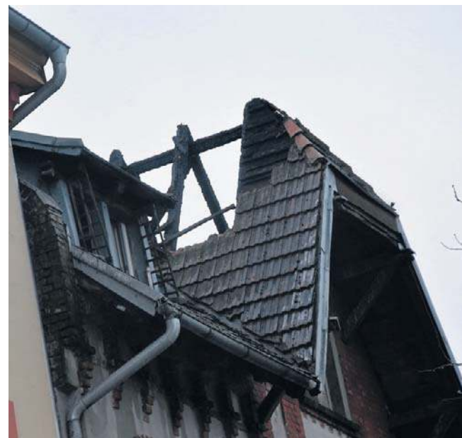
Spłonęło niezamieszkałe poddasze. Na szczęście ogień nie rozprzestrzenił się na niższe kondygnacje
