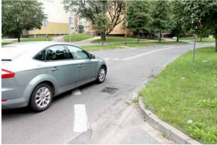
Widać, że jadący jest zmuszony tak wymanewrować auto, by nie wpaść w zagłębienie asfaltu. Dodatkowym utrudnieniem jest studzienka.
