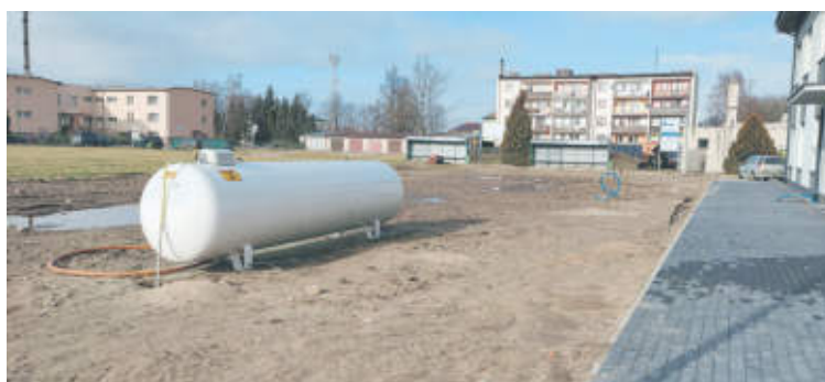
Zbiornik gazu za nową siedzibą urzędu gminy w Jabłonie Lackiej. Ale gaz z sieci ma być tańszy...
