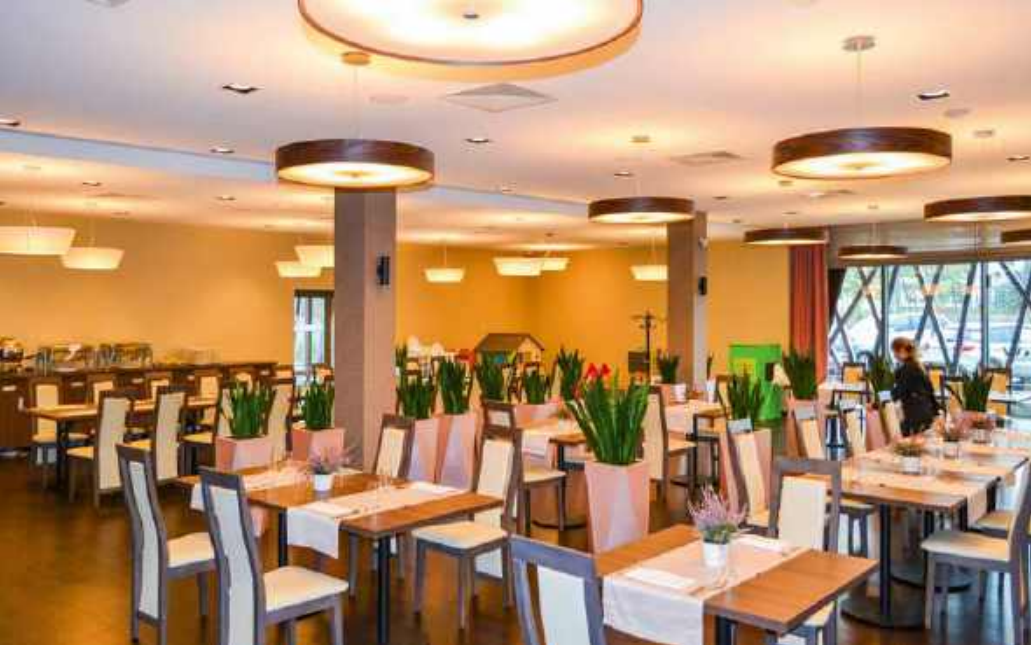
15 głośników sufitowych zapewniających bardzo równomierny rozkład pola akustycznego w hotelowej Restauracji Podpromie.
