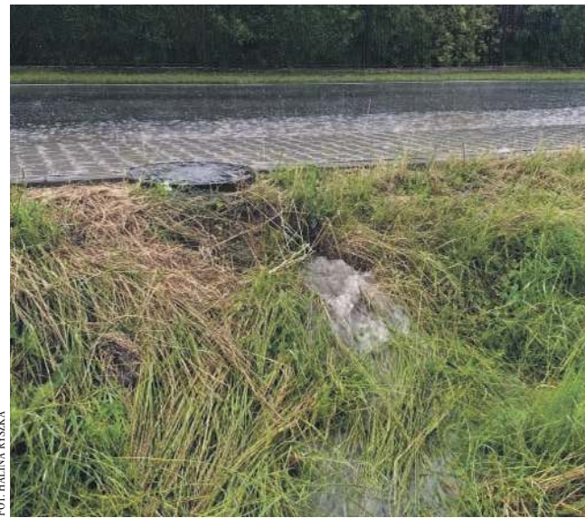
Podczas ulew woda wypływa ze studni chłonnej
