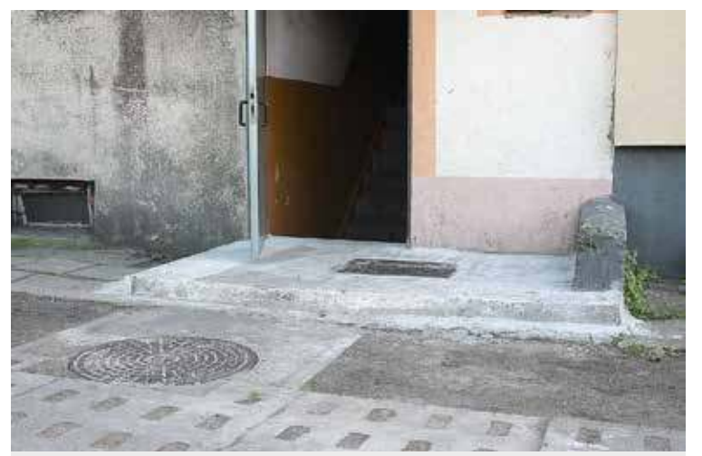
Mieszkańcy tego bloku musieli sobie wybudować zaporę, aby woda z drogi nie wlewała się do klatki i piwnicy
