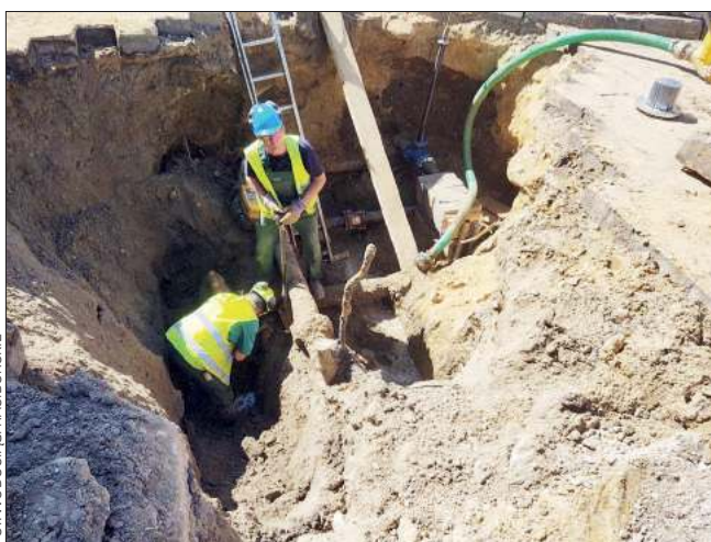
Usuwanie awarii wodociągu trwało trzy dni. Konieczna była całościowa wymiana uszkodzonej instalacji
