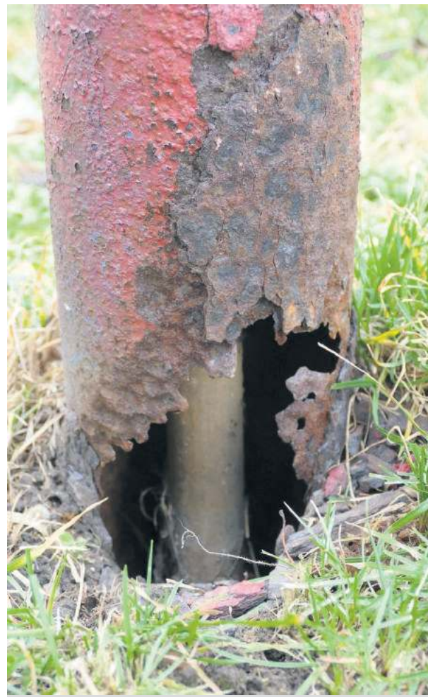
Dziurawy hydrant zostanie naprawiony
