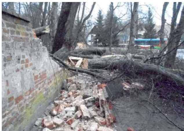
Silny wiatr przewrócił drzewo, które upadając uszkodziło parkowy mur od strony ul. Kazimierskiej w Puławach
