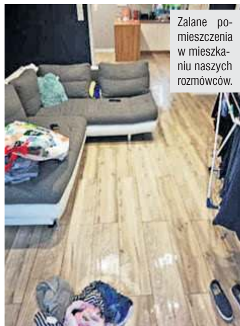
Wilgoć weszła kilkanaście centymetrów w górę ścian.
