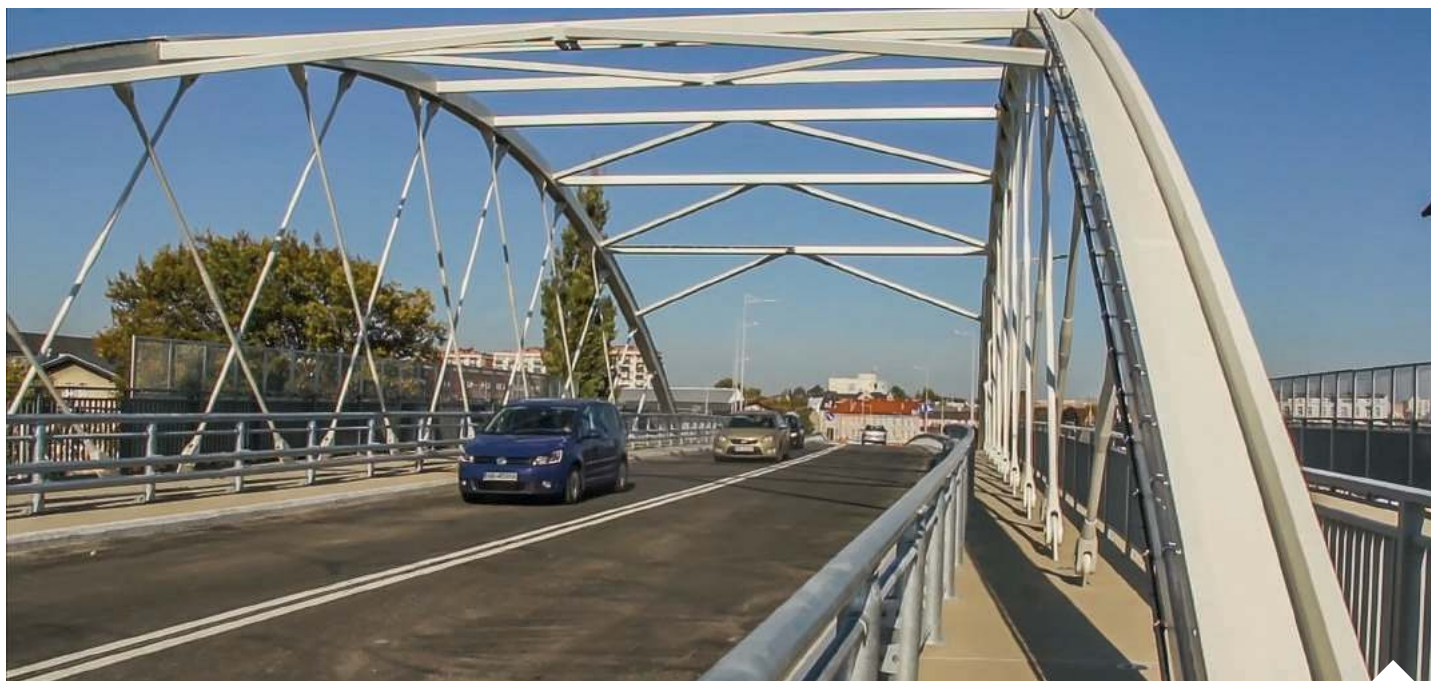
Inspektor nadzoru budowlanego stwierdził liczne błędy w konstrukcji elbląskiego wiaduktu | fot. YouTube/d
