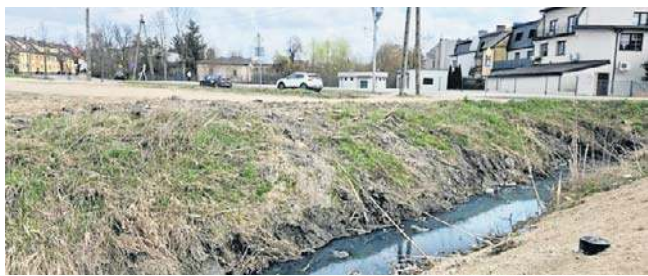
Cuchnący rów przy ul. Belwederskiej w Łęczycy
