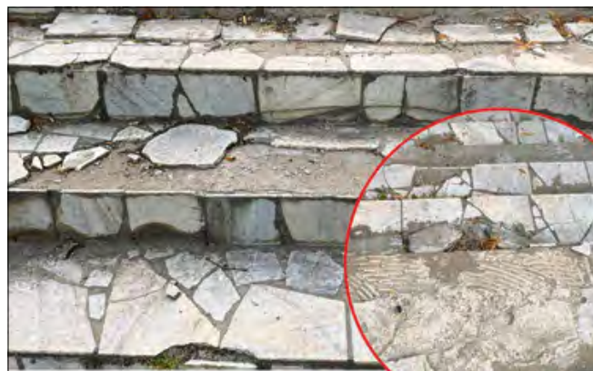
Zaniedbania w infrastrukturze w okolicach pieszego zejścia z mostu nad Odrą w kierunku Mariny.
