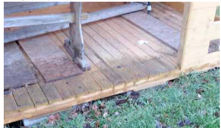
Wilgoć już wżera się w podłogę tarasu
