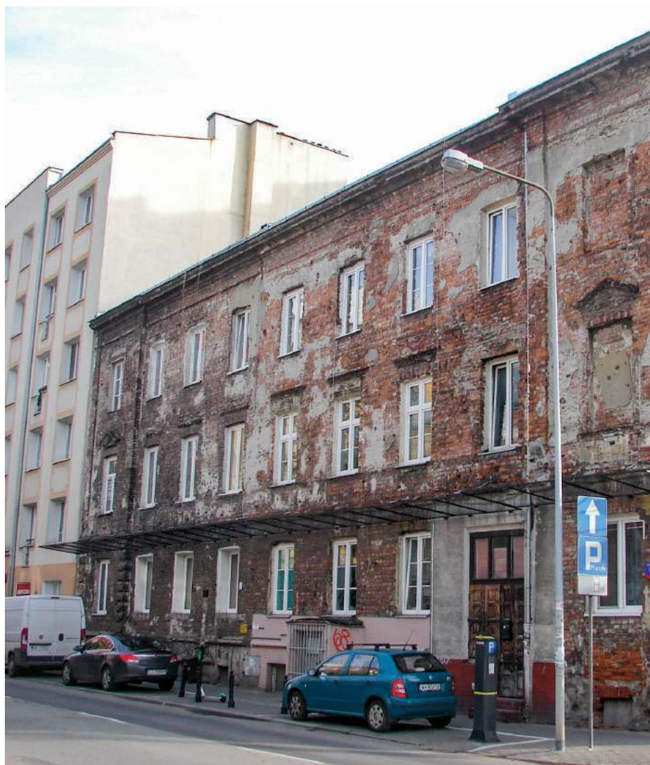
Pozbawiona tynków elewacja Wrzesińskiej 14 i fragment zachowanego wystroju sztukatorskiego | fot. Janusz Sujecki
