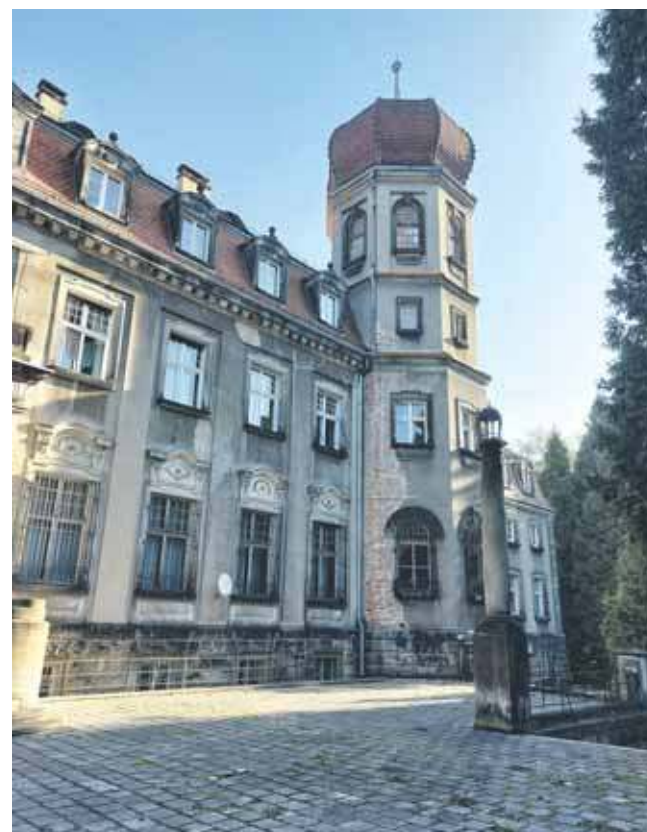
Pałac w Brynku jest zaniedbany i wymaga pilnych remontów
