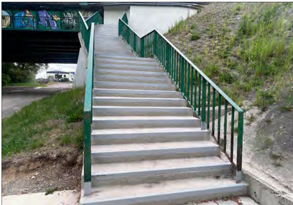
Schody po opadach deszczu są bardzo śliskie.
