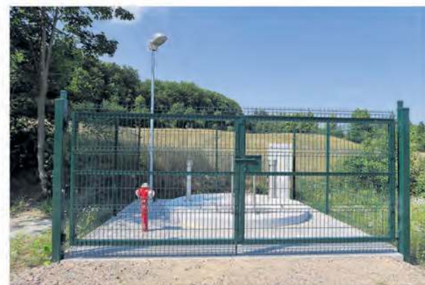
Tłocznia ścieków S11 w miejscowości Charzykowy
