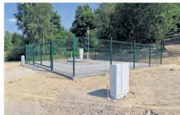
Tłocznia ścieków S7 w miejscowości Charzykowy
