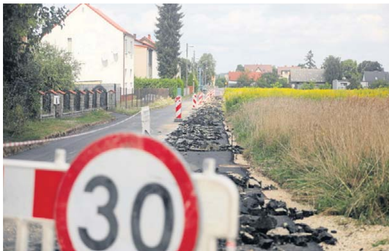
Droga przeorana przez ciągnik ma zostać naprawiona
