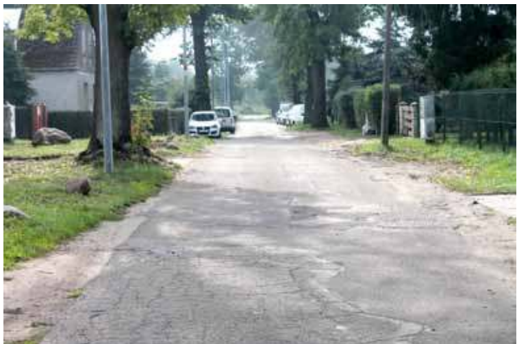
Tak wygląda obecnie droga na ul. Granicznej. Mimo że nie jest to jedna z głównych miejskich ulic, to ruch na niej jest spory
