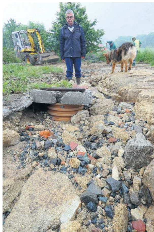
Na zdjęciu widać fragment podmytej i przechylonej studzienki kanalizacyjnej
