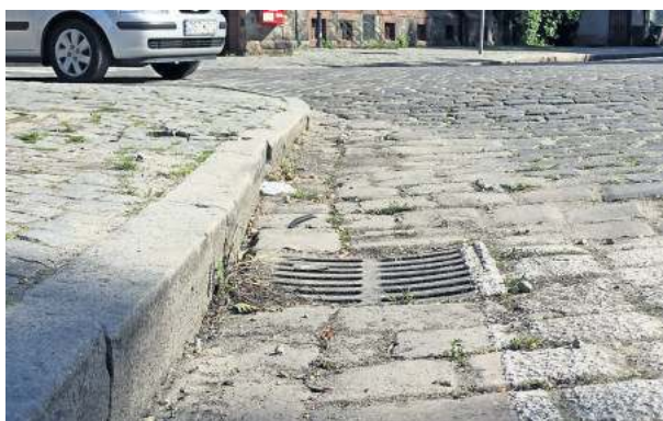
Nagle ulewę pokazują, że kanalizacja deszczowa w Strzelinie jest w niektórych miejscach niewydolna
