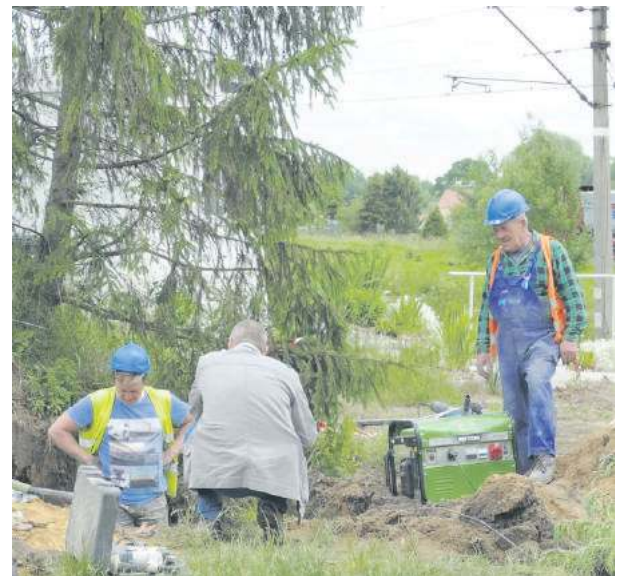
Policjanci z Zespołu Dochodzeniowo-Śledczego z Komendy Powiatowej Policji w Strzelinie rozpytywali kierownika robót
