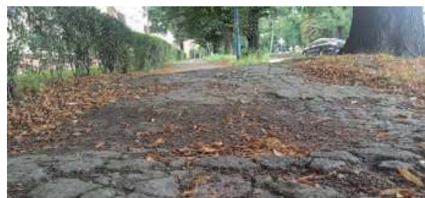
Temu chodnikowi na ul. Staszica w Strzelinie przydałby się remont. Gmina ma jednak związane ręce, gdyż nie jest on własnością publiczną
