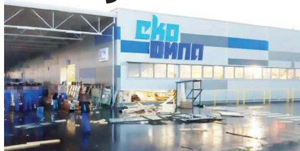
Uszkodzenia na zewnątrz budynku
