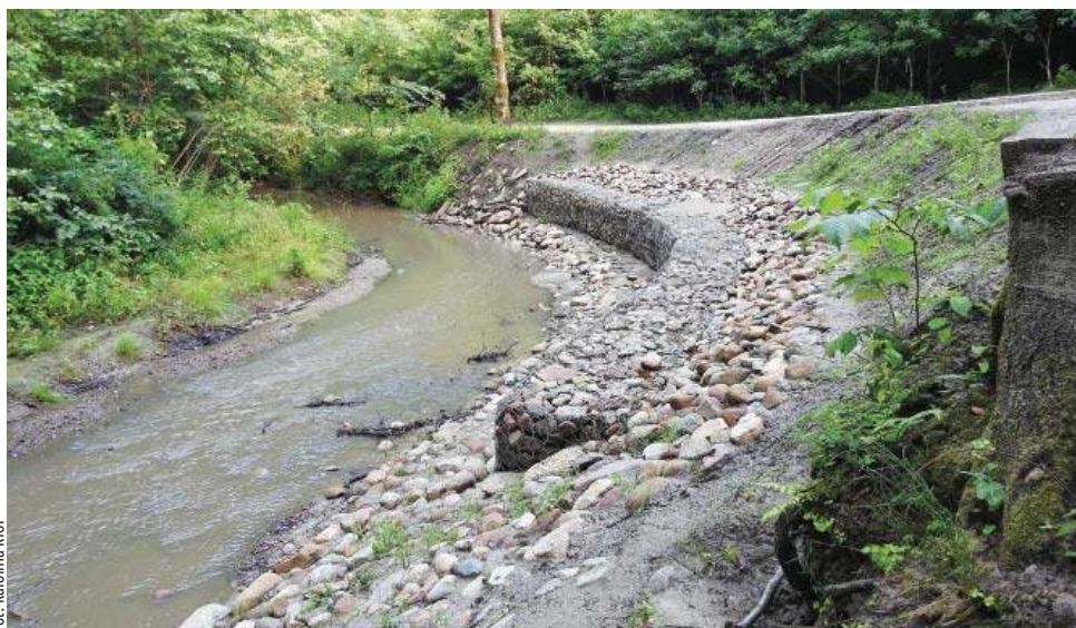
Remontowany odcinek Srebrnego Potoku został uregulowany wiele lat temu
