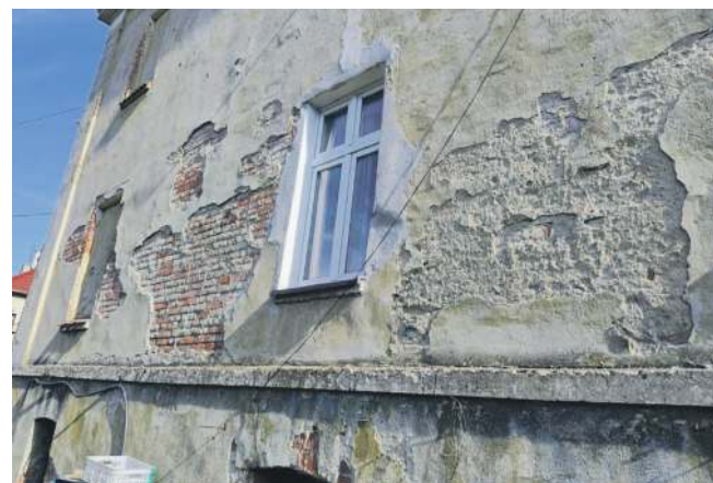
Tynk leci z elewacji
