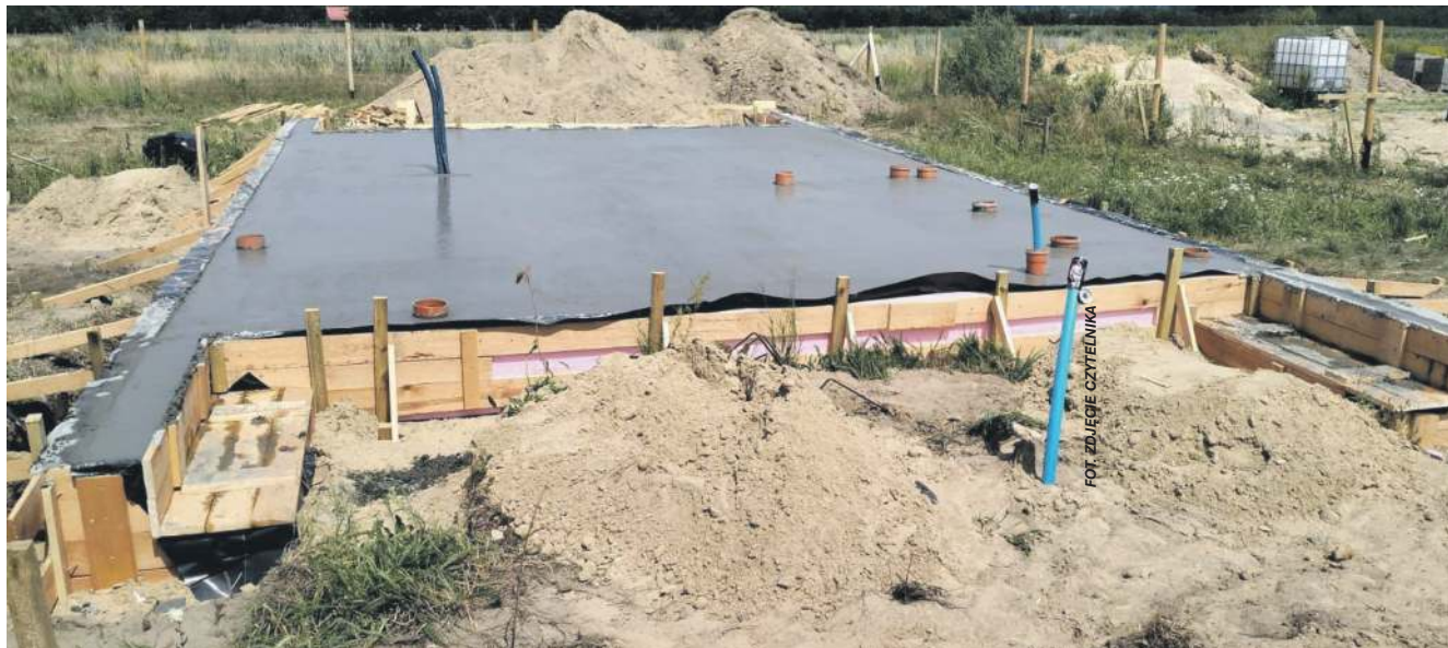
To tutaj miał stanąć dom dla kobiety i jej syna. Po tym, jak wykonawca zniknął z pieniędzmi, inwestycja utknęła na etapie płyty fundamentowej
