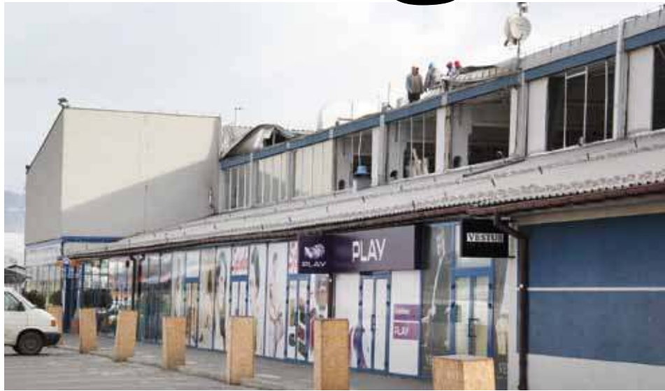
Uszkodzony dach nowotarskiej galerii E.Leclerc.
