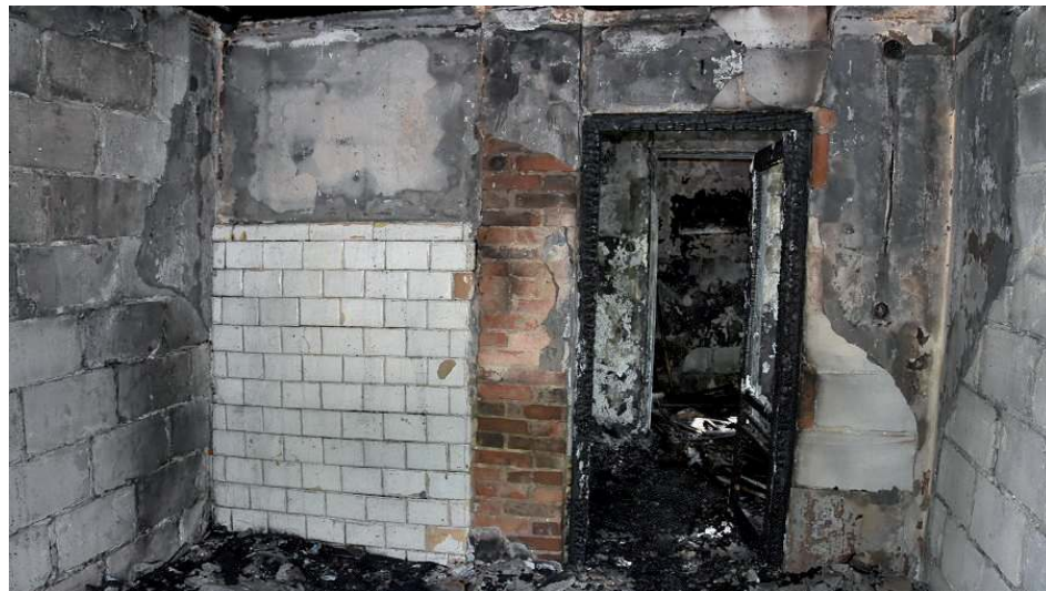
Skutki podpalenia niezamieszkałego domu
