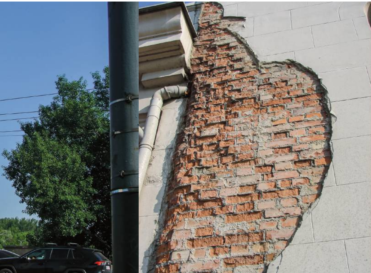
Praska, północna wieżycza mostu Poniatowskiego i fragment niszczonej elewacji | fot. Janusz Sujecki/Gazeta Polska
