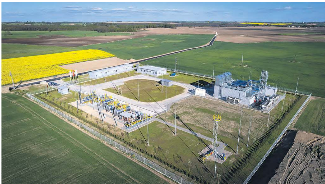
Elektrownie modułowe wybudowane przy złożach gazu w Bajerzu i w Sicinkach (gmina Kęsowo) wyglądają identycznie.
