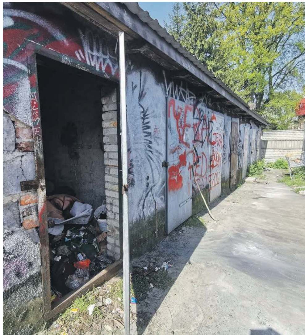
Zniszczone komórki lokatorskie
