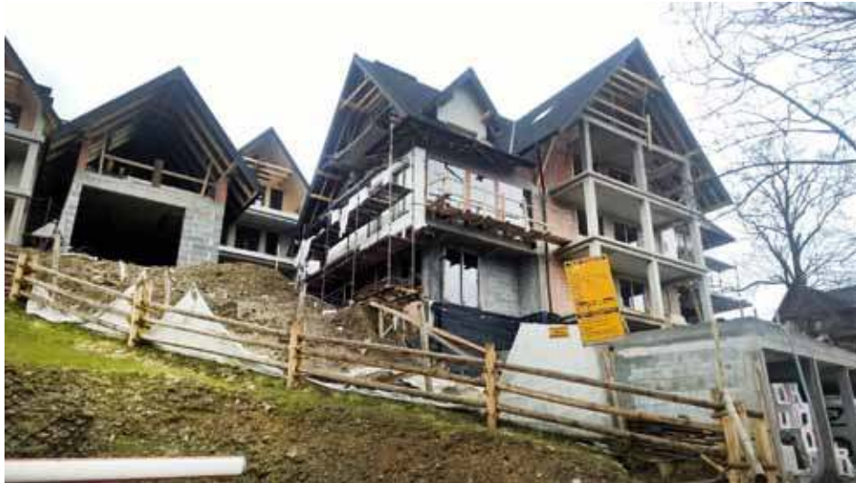
Długość, szerokość, wysokość, kubatura i liczba kondygnacji są niezgodne z planem budowy, na który wydano zezwolenie.
