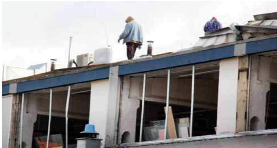
Zniszczenia, które spowodowała wichura na dachu jednej z galerii handlowych w Nowym Targu.
