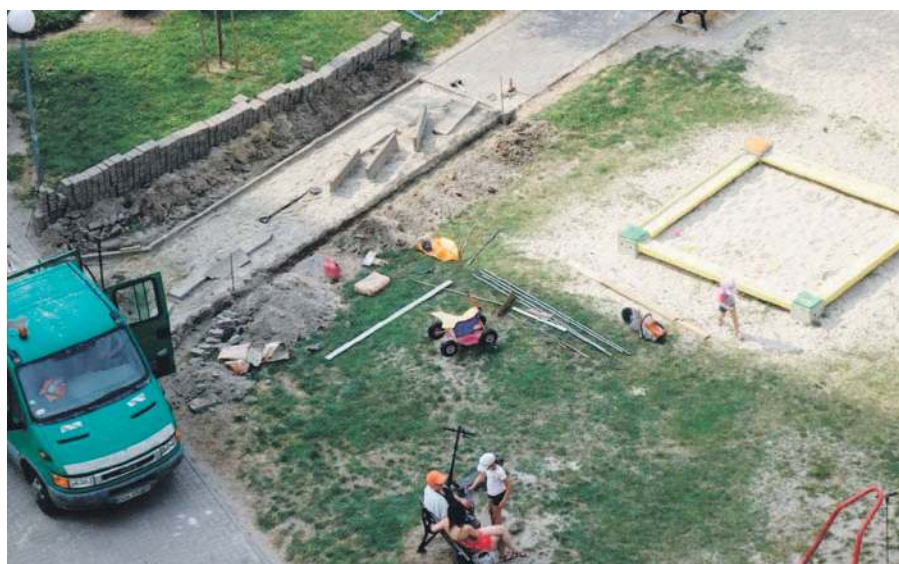
Ekipa remontowa nie ogrodziła placu budowy, a narzędzia rozłożyła na placu zabaw wśród bawiących się dzieci
