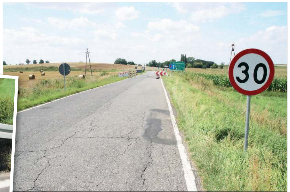
W wyniku szkód czasowo wprowadzono ograniczenia w ruchu w ciągu drogi
