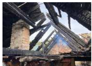
W domu w Gąsierzynie spłonął dach (fot. KP PSP Goleniów)
