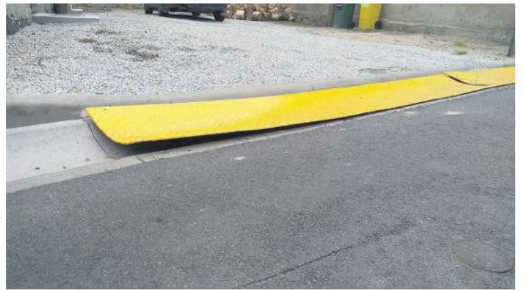
Podczas przejazdu samochodów blacha wygina się i może uszkodzić opony
